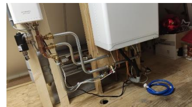
Figuur 1 Installatiedetail van een hybride systeem: rechts de gasketel, links de warmtewisselaar (binnen-deel) van de Lucht-Water Warmtepomp
