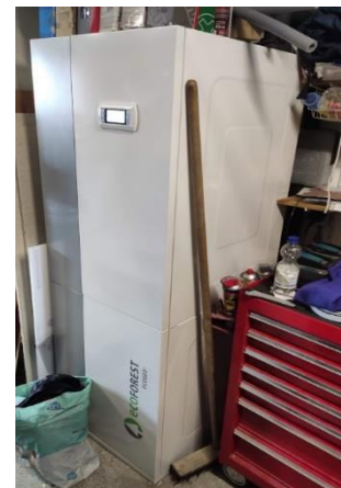
Figuur 2. Warmtepomp met geïntegreerd boilervat. (van het Aquathermie systeem)
