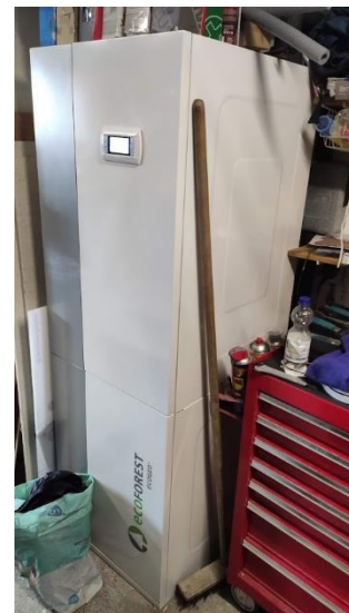
Figuur 2. Warmtepomp met geïntegreerd boilervat. (van het Aquathermie systeem)
